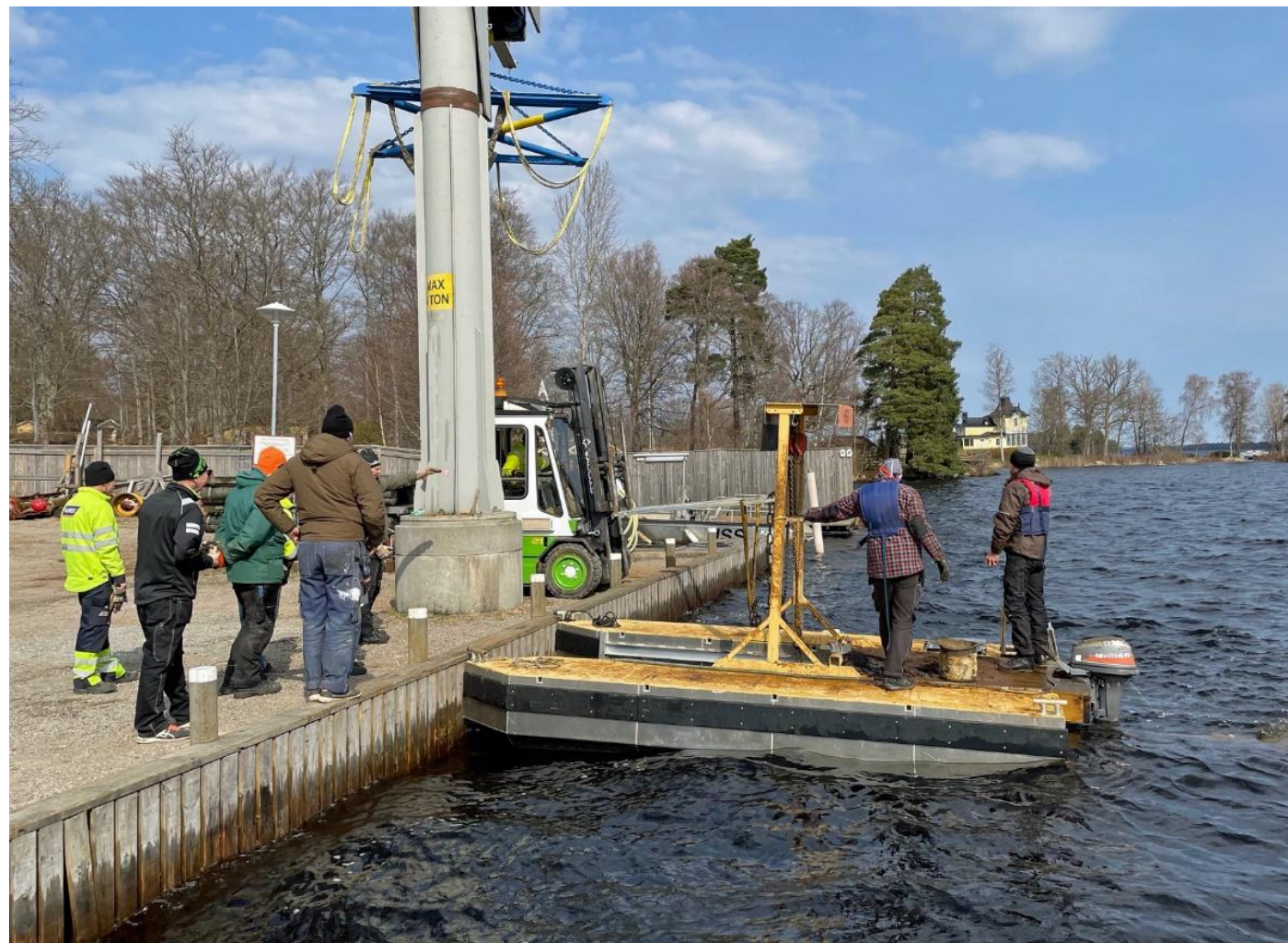
HSS varv, kaj och pelarkran ger möjlighet att hantera tyngre utrustning.
